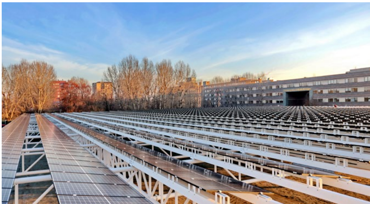
Il nuovo Parco Fotovoltaico del Centro Servizi di BPER Banca a Modena
